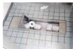
▲トイレトペーパーの詰め込み
